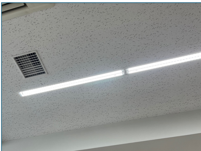
てんじょう けいこうとう 天井の蛍光灯
